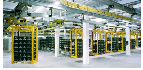
SingleFlexLine 0811 Bira fabrikasındaki elektrikli tek ray konveyör sistemi
