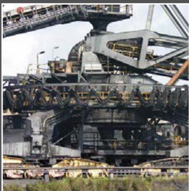
Подвесная кабельная система на Стакере/Реклеймере, Австралия
