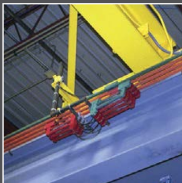
Шинопровод на обслуживающем кране, Китай
