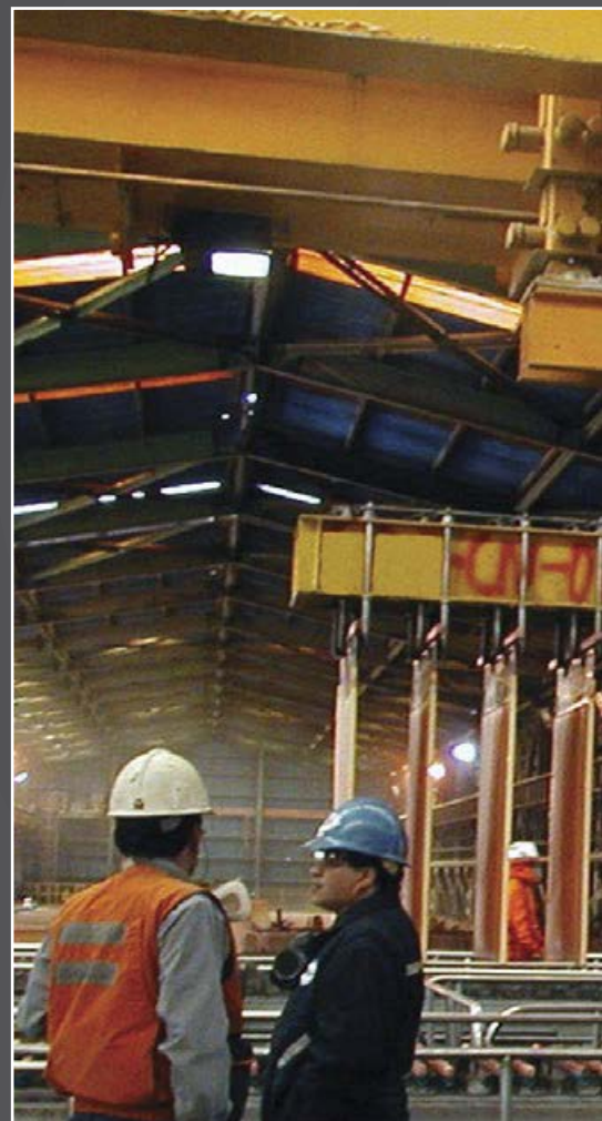
Троллейный шинопровод и подвесная система на процессинговом кране, Чили
