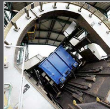
Троллейный шинопровод на вагонопрокидывателе, Австралия
