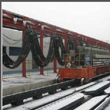
Подвесная система на вагонопрокидывателе, Китай
