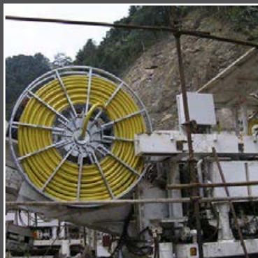
Приводной кабельный барабан на туннелепроходческой машине, Индия
